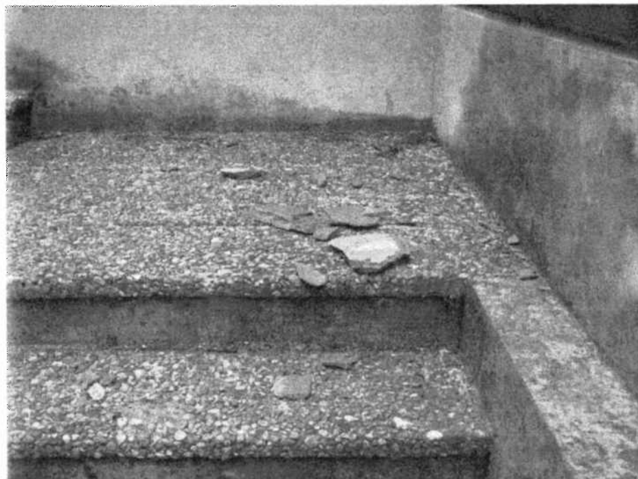
Fig. 8 Particolare elementi caduti
