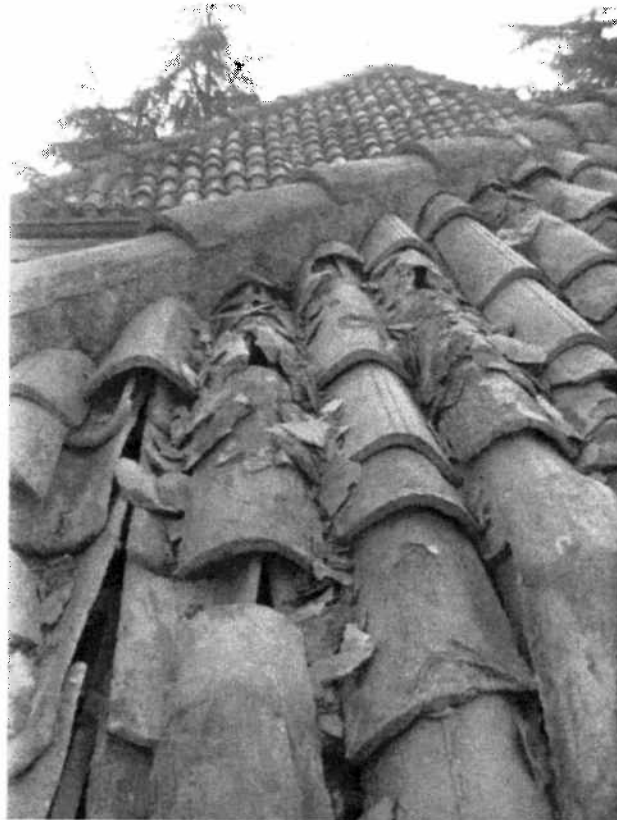
Fig. 10 Dissesto localizzato del manto in coppi
